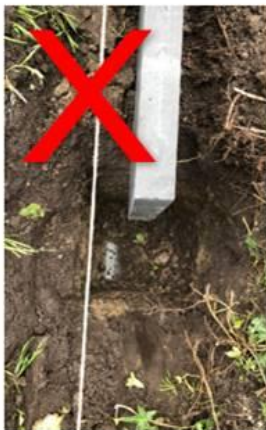
Rioleringen dienen verwijderd te zijn
